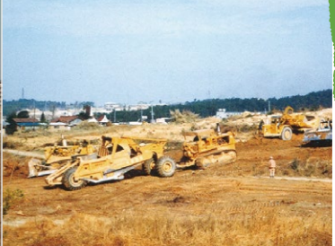
1 1975年から始まった岡崎上地土地区画整理事業。大きな建設機械が山を削っている
